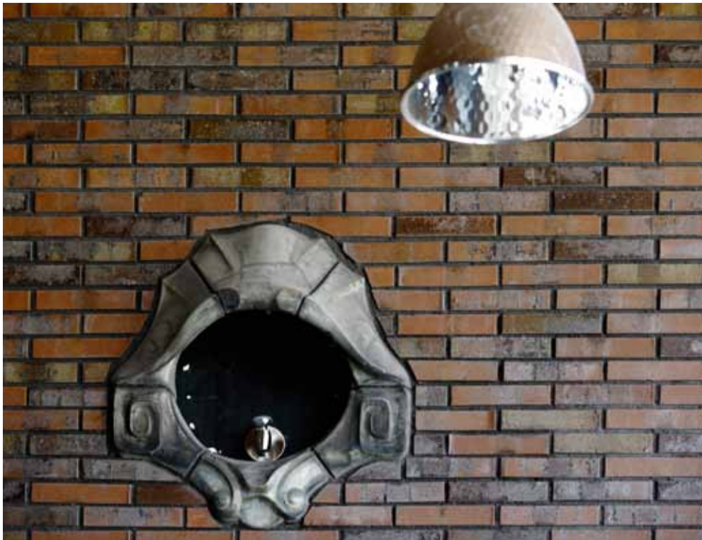
Rond 'De Villa' waren vroeger drie vleugels gebouwd met – volgens Duwo-projectleider Arjo Boerstra – 'dode gevels' aan de Michiel de Ruyterzijde. "Niet echt fraai", zegt hij. Bij de sloop daarvan werden de ventilatieornamenten voor de luchtafvoer van zuurkasten gespaard en in de nieuwe entreehal ingemetseld. Gewoon voor de sier. Nu te zien met verlichting erin, maar tijdens de leegstand van het pand met broedende duiven. Die bleken tijdens de bouw erg trouw en zijn daarom gevangen en afgemaakt, meldt Boerstra. Ze poepten heel de boel onder.
